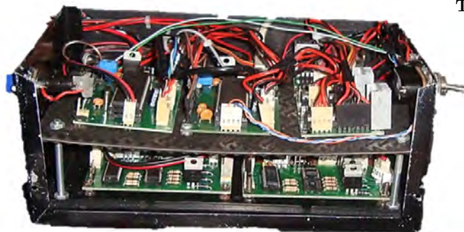
Figura 6. Caja de controladores.
